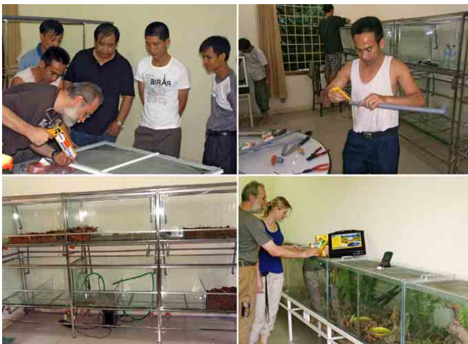
Abb. 10: Aufbau der Amphibieninnenanlage und Einweisung der vietnamesischen Mitarbeiter in den Terrarienbau (oben), der erste Sechser-Block der Amphibienanlage kurz vor Fertigstellung (links unten) und die neue Quarantänestation (rechts unten). Construction of the amphibian indoor enclosure and briefing of the Vietnamese colleagues in terrarium building (top), the first six amphibian enclosures shortly before completion (bottom left) and the new quarantine station (bottom right).
