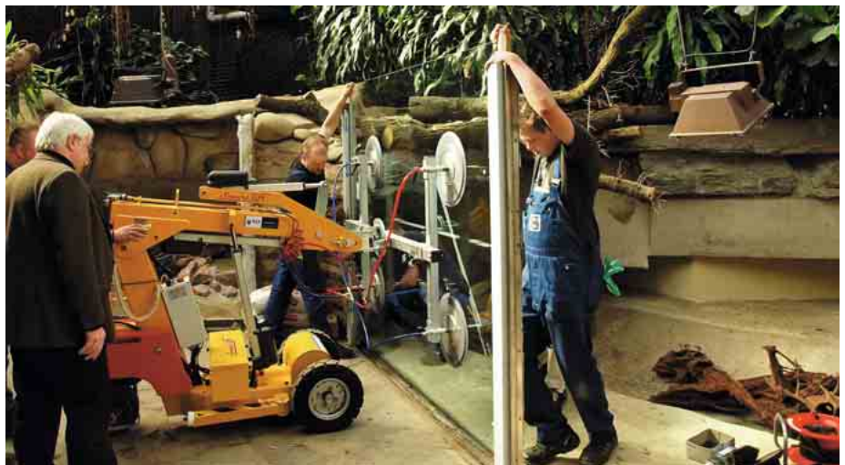
Abb. 29: Mitte März 2011: Die Glasscheiben werden installiert. Mid-March 2011: Mounting of the glass panes.
