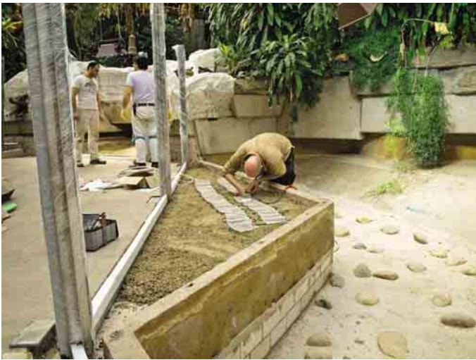
Abb. 23: Im Februar 2011 waren bereits die neuen Pfeiler angebracht, der Bodengrund des Flussbettes erhöht und die Grobstruktur des Kunstfelsens der im Hintergrund angrenzenden Warananlage modelliert.
