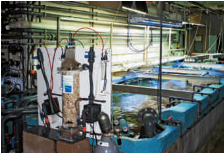
Abb. 3: Hinter den Kulissen des Riffaquariums wird die aufwändige Technik erkennbar, z.B. der große Kalkreaktor im Vordergrund. Behind the scenes of the reef aquarium the extensive technical installations are discernible, for example the lime reactor in the foreground. (Foto: Thomas Ziegler)
